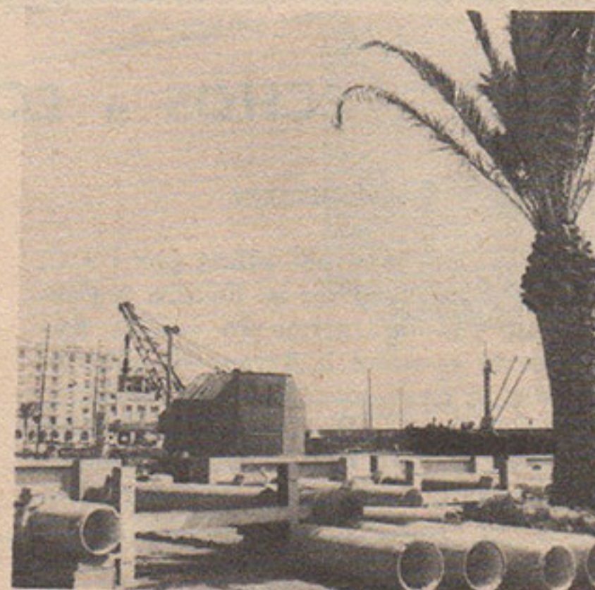
La reconstruction mène bon train à Saint-Raphaël au milieu des végétations typiques de la côte.
